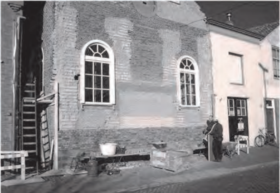
De Sjoel tijdens de restauratie met rechts het bijgebouw dat door een gelukkig toeval kon worden verworven. Foto ds. E. Rietveld.
