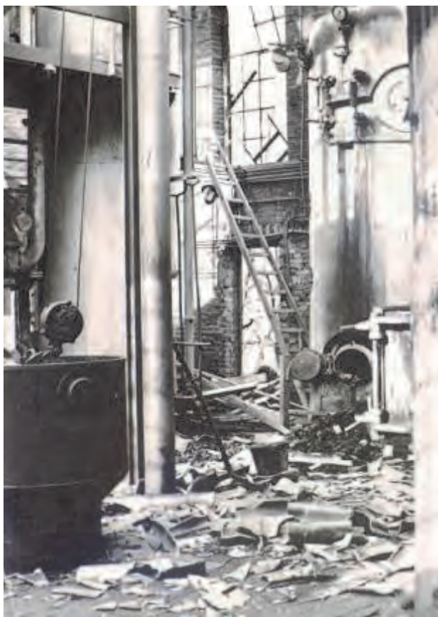
Afb. 10: Schade aan de installaties als gevolg van de explosie op 19 februari 1957, om half tien 's ochtends. Foto Collectie SVPR.
